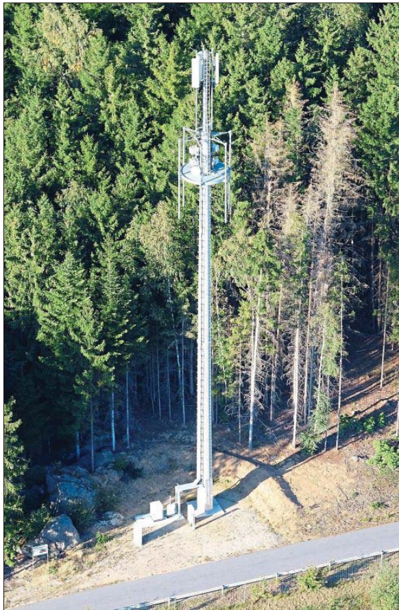
Die Telekom rüstet auf: Seit kurzem steht in der Gemeinde Weiding ein neuer Mobilfunkmast. Foto: Daniel Paul
