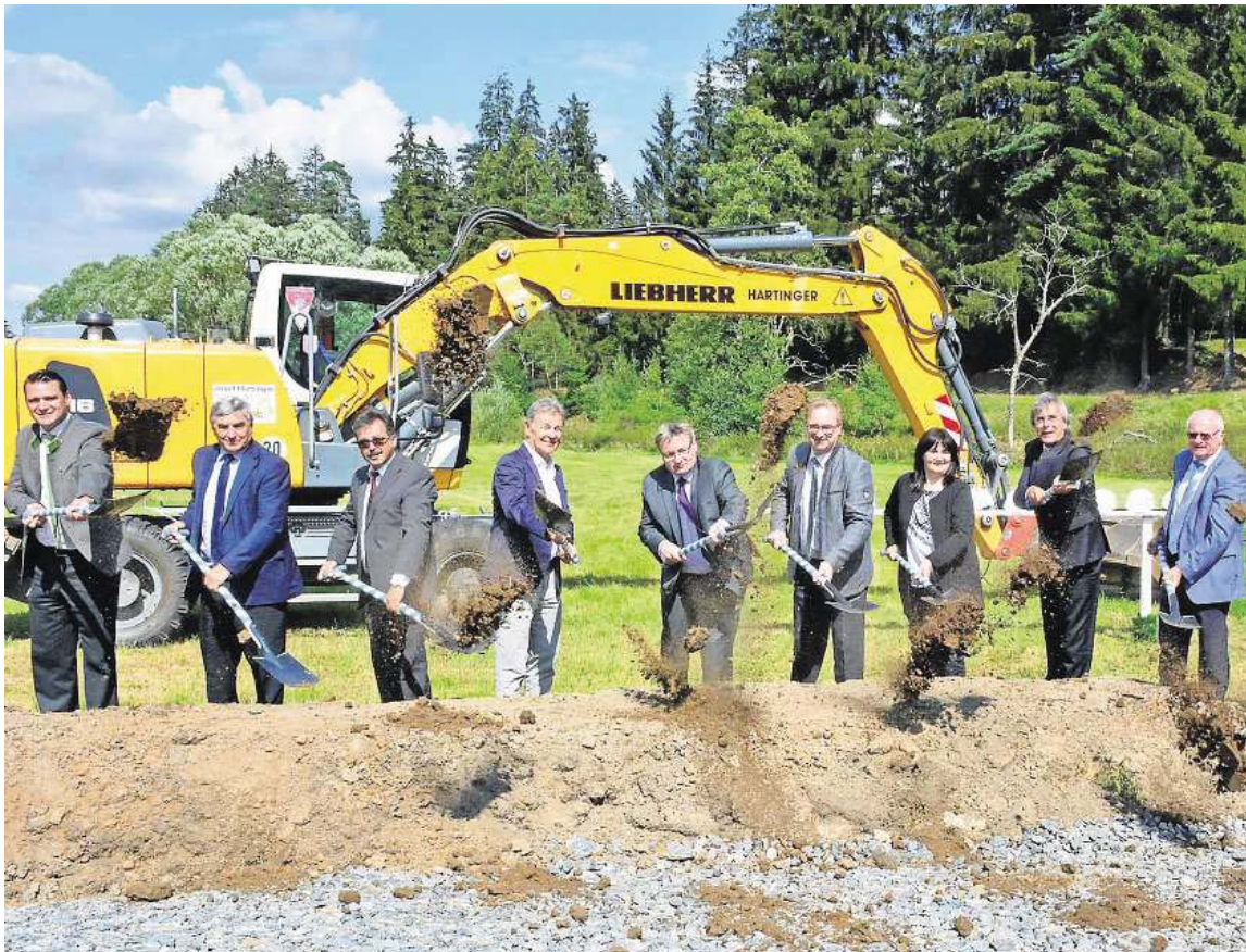
Mit dem obligatorischen Spatenstich durch die Ehrengäste nimmt endlich der Ausbau der Staatsstraße 2159 südlich von Gaisthal Fahrt auf.
