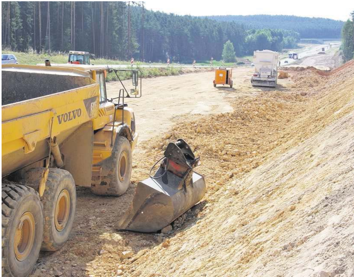
Am Unterbau der beiden neuen Fahrbahnen der Bundesstraße 85 Richtung Pittersberg wird fleißig gearbeitet.
