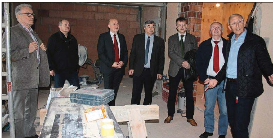
Architekt Hans Engl (rechts) führte durch die Baustelle; hier entsteht die Tagespflege.
