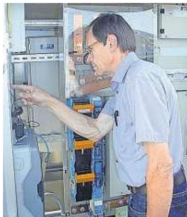
Franz Zollner, Vorstand Energielandkreis Cham e. G., rief in der Schaltzentrale die aktuellen Leistungsdaten ab.
